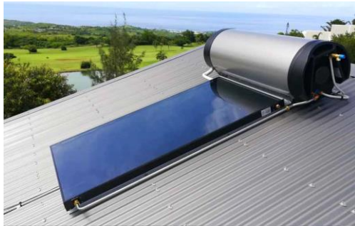
Chauffe-eau solaire individuel
