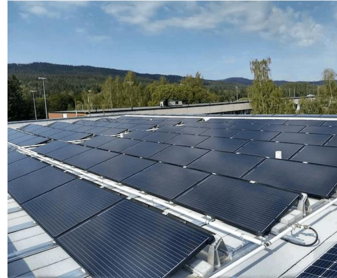
Chauffe-eau solaire collectif
