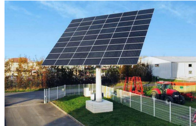
Installation en trackers (suiveurs) pour consommation directe sur site (autoconsommation)
